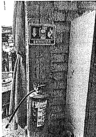
Fig. 3 Primer extintor contra incendios en el centro de acopio del C. JOSÉ ÁNGEL JUÁREZ
